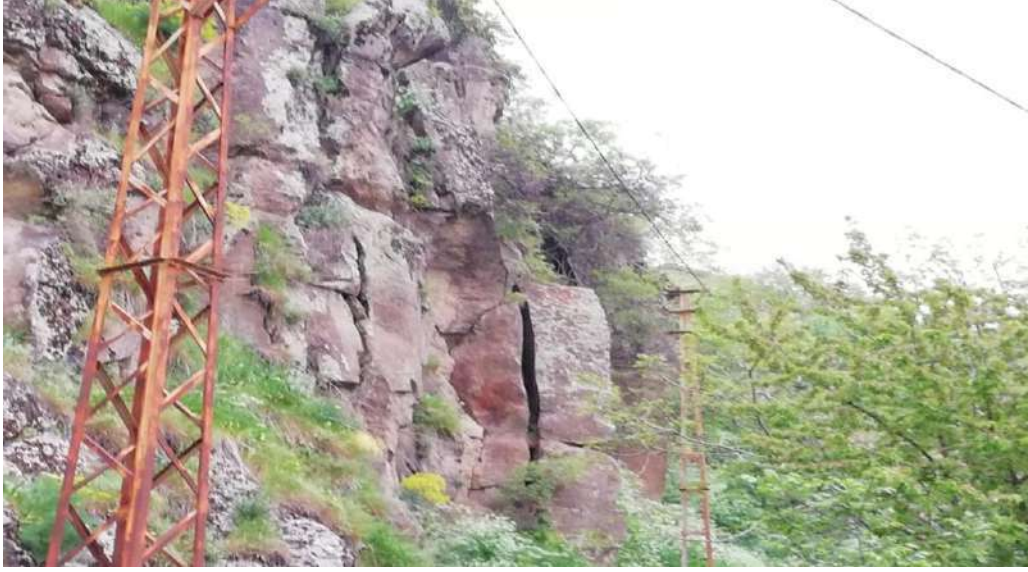
Şekil 6. Şevlere paralel kaya çatlakları
