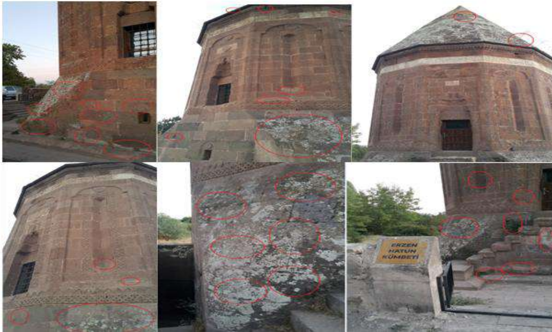
Şekil 3. Erzen Hatun Kümbetinde gözlemlenen hasarlar
