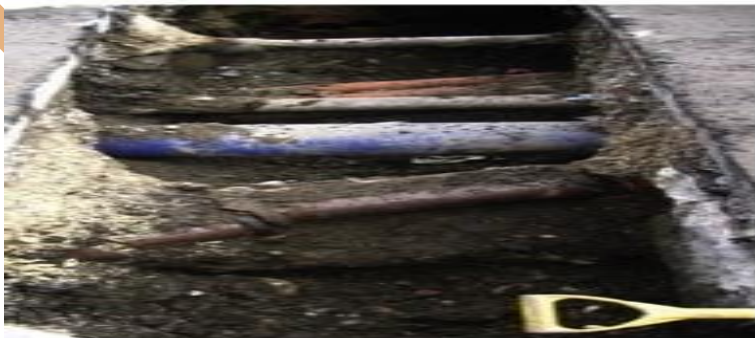
Şekil 3: Asfalt altında tespit edilen teknik altyapılar (Metaly, 2014).
